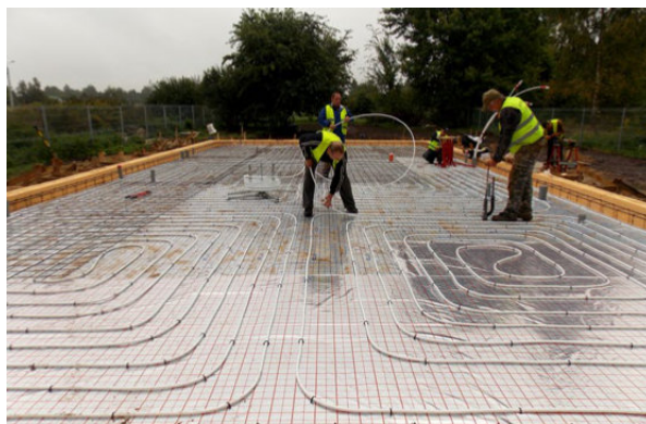
System ogrzewania podłogowego „zatopiony” w płycie fundamentowej.
