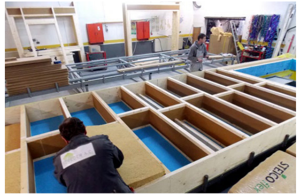
Prefabrykacja ścian STEICO w zakładzie SZREDER A.C.: słupki ścienne z belek dwuteowych STEICOWall 60×360 mm, oczep i podwalina ze STEICO LVL R 39/45×360 mm; termoizolacja STEICOflex 038 360 mm oraz STEICOPROTECT H 60 mm.
