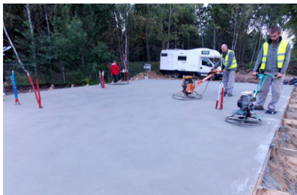
System ogrzewania podłogowego „zatopiony” w płycie fundamentowej.
