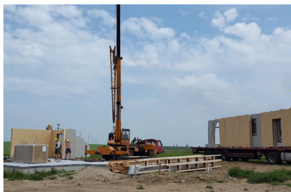
Dostarczenie prefabrykowanych ścian zewnętrznych STEICO na plac budowy (ściany pokryte zaprawą klejąco-zbrojącą, wyposażone w stolarkę okienną i drzwiową); posadowienie i zakotwienie ścian do płyty fundamentowej.
