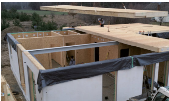
Dostarczenie prefabrykowanych elementów stropowych STEICO na plac budowy; montaż konstrukcji stropu na ścianach parterowych.
