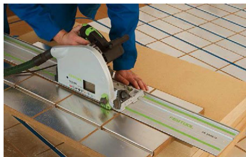
Montaż systemu ogrzewania podłogowego IDEAL ECO. Grubość płyty izolacyjnej STEICO 30 mm. Źródło: JUPITER Heating Systems Limited.
