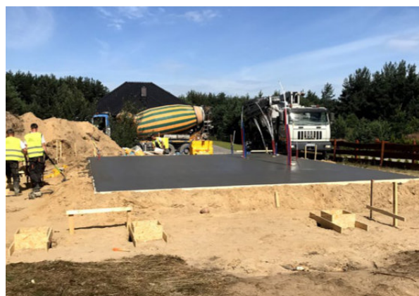
Prace ziemne; przygotowanie płyty fundamentowej. System ogrzewania podłogowego „zatopiony” w płycie fundamentowej.
