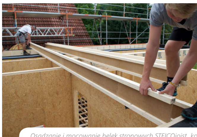
Osadzanie i mocowanie belek stropowych STEICOjoist, korzystając z nacięć w belkach czołowych.
